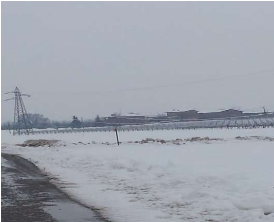
Linea 132 kV 23.637 Spilamberto-Vignola conduttori prossimi al terreno.
