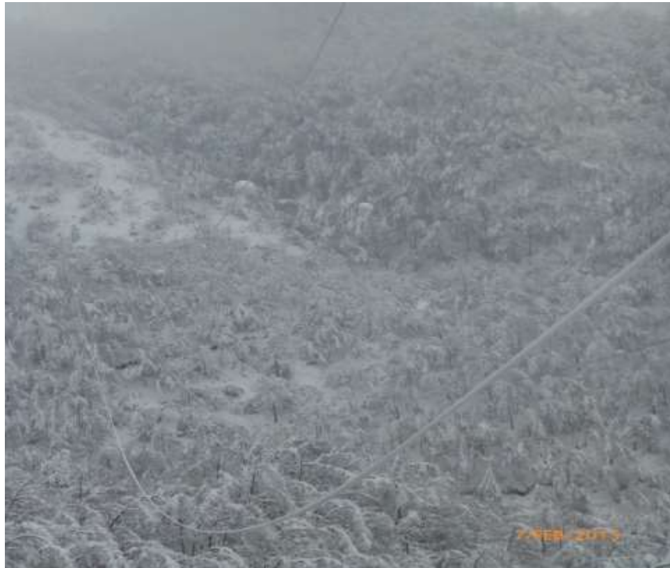
Linea 132 kV 785 Isola Ridracoli – Quarto campata 20-21.
